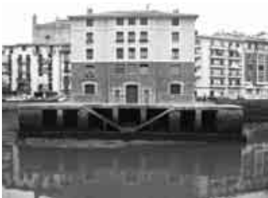
Fig. 12. Tablestacado de protección de la cimentación de una casa de vecinos en la ría de Ondarroa (2004)
