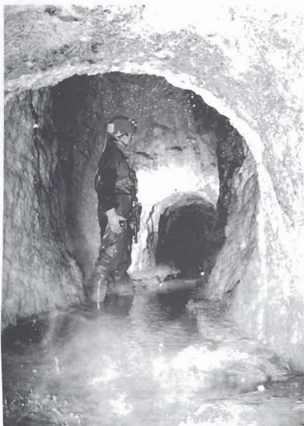
Figura 13. Vista general de la galería del socavón de Arditurri. Foto Felix Ugarte Elkarte.
